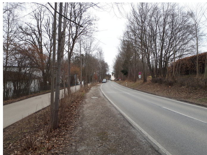
Notdürftig befestigter Haltestreifen entlang der St2070 (Blick von Süden aus in Richtung Starnberg) [6]
